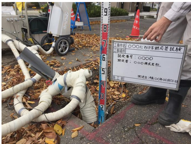
写真-3 熱交換器頭頂部写真 Uチューブの頭頂部と TRT 測定装置の配管状況の写真
